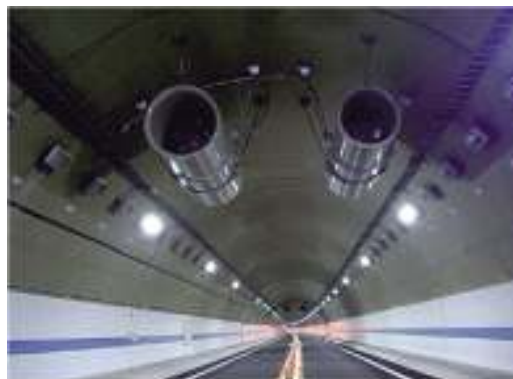
トンネル 換気ファン
