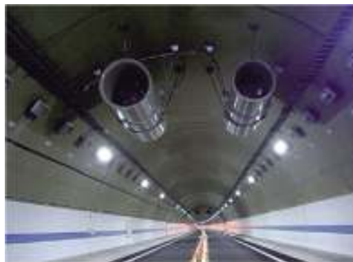
トンネル 換気ファン
